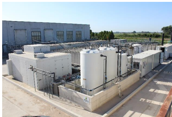
Impianto di depurazione del percolato di Torretta.
