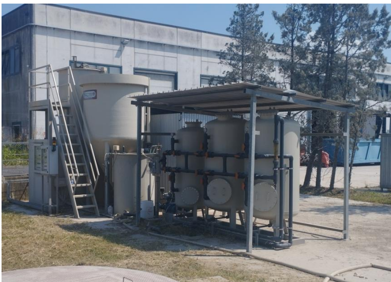
Foto 10 impianto trattamento acque prima pioggia
