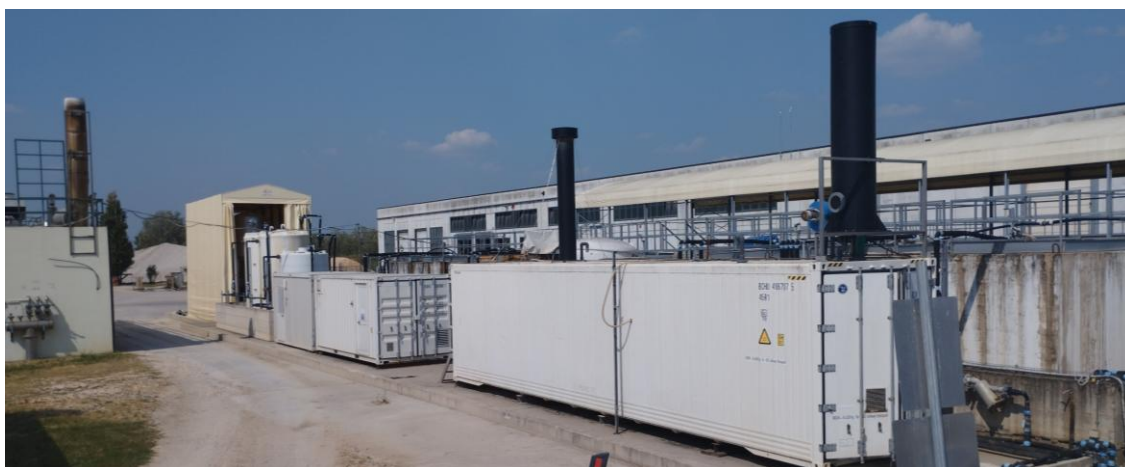
Foto 5 Impianto trattamento percolato
