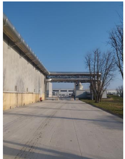
Foto 11 vista condotte aria biofiltro
