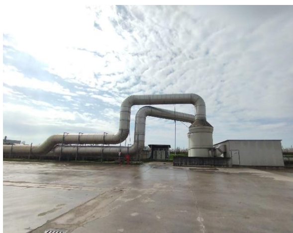
Foto 2 impianto trattamento aria (scrubber)
