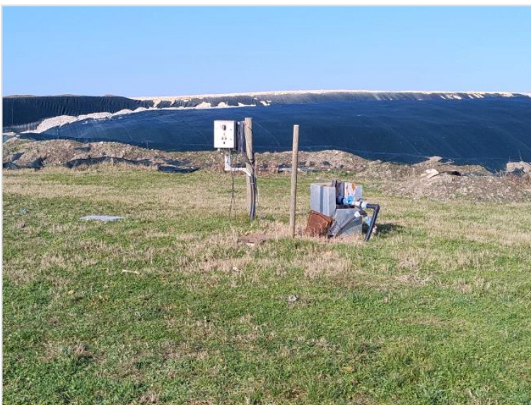
Foto 12 pozzo percolato lotto A
